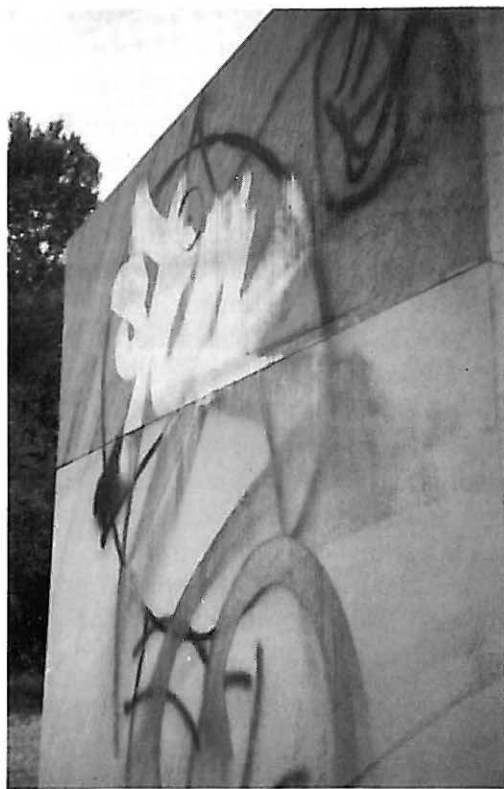
Scorcio del pilastro del Sole in marmo di Peccia, imbrattato prima della posa del modello.
